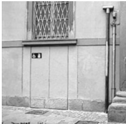
Un esempio di intervento ben riuscito su un edificio storico: l'ascensore è mimetizzato nella facciata usando lo stesso intonaco del muro
